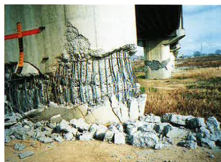
図-2.11 小判形 RC 橋脚の被災状況の拡大
