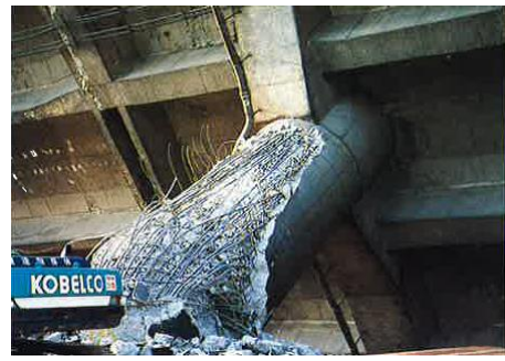
図-2.5 ピルツ橋の被災（その2）
