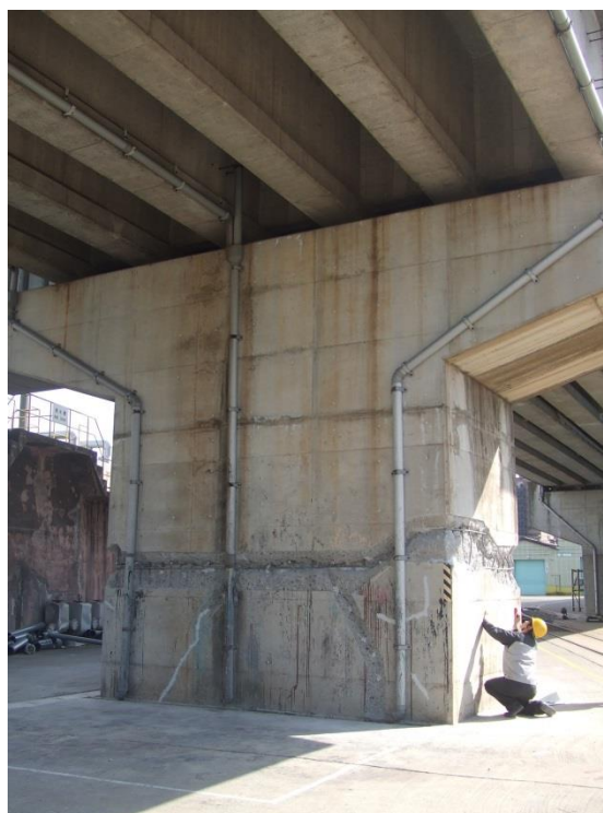
図-1.1 既設 RC 橋脚における段落し部の損傷
