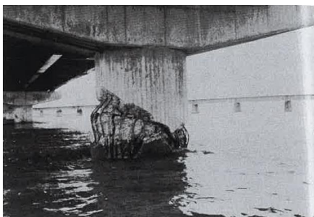
図-2.1 静内橋3P橋脚の損傷
