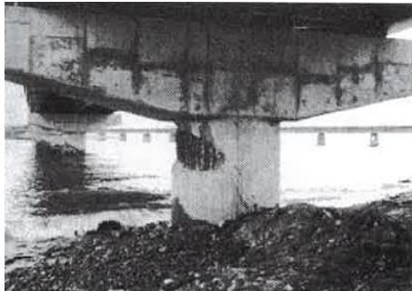
図-2.2 静内橋2P橋脚の損傷
