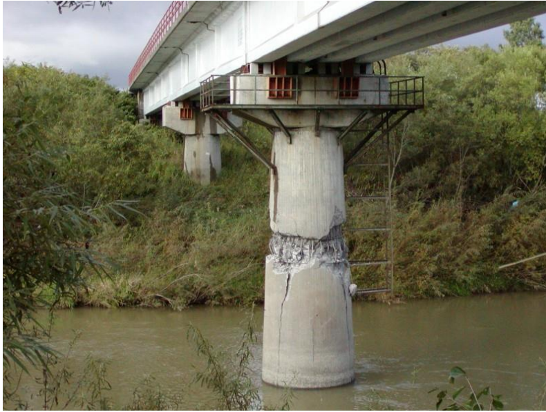
図-2.13 浦幌川橋梁 RC 橋脚の損傷
