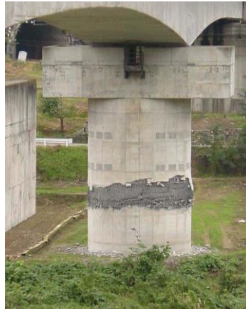
図-2.14 魚野川橋梁 RC 橋脚の損傷
