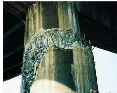
図-2.9 円形 RC 橋脚の被災（その2）
