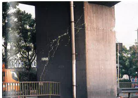
図-2.6 矩形 RC 橋脚の被災（その1）
