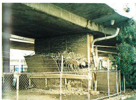
図-2.12 壁式 RC 橋脚の被災
