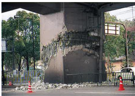
図-2.7 矩形 RC 橋脚の被災（その2）
