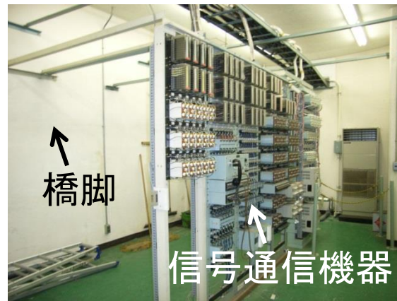
(b) 機器室内部の状況
