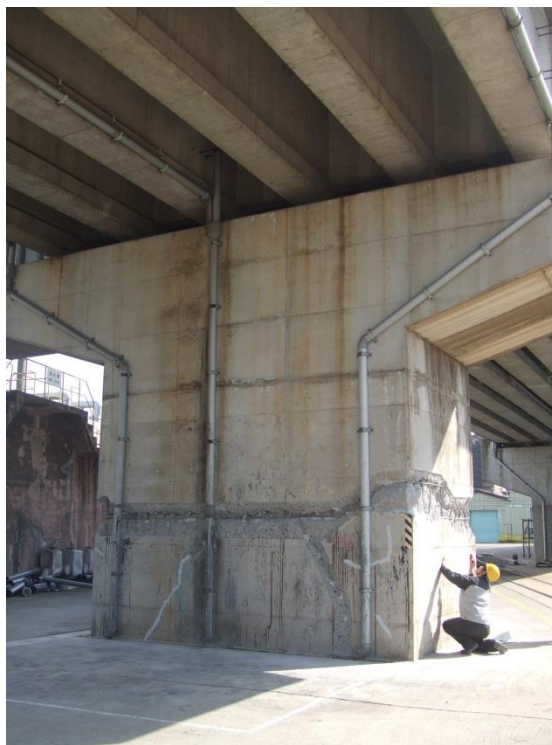
図-6.37 壁式橋脚段落し部の損傷（再掲）
