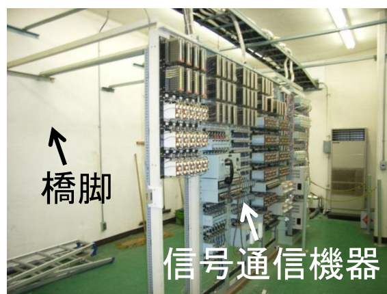
(b) 機器室内部の状況
