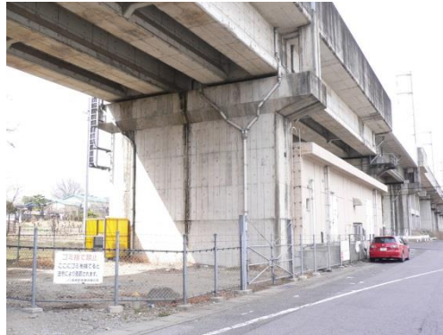
図-1.3 高架下を機器室に使用している橋脚
