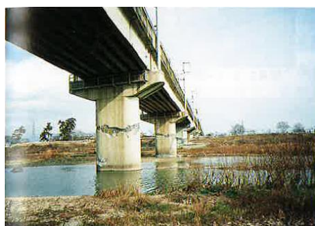
図-2.10 小判形 RC 橋脚の被災
