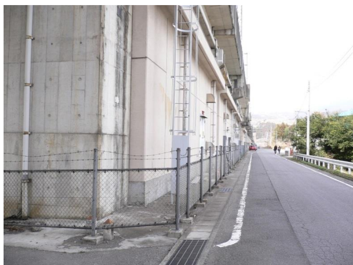
(a) 高架下利用状況（信号通信機器室に利用）
